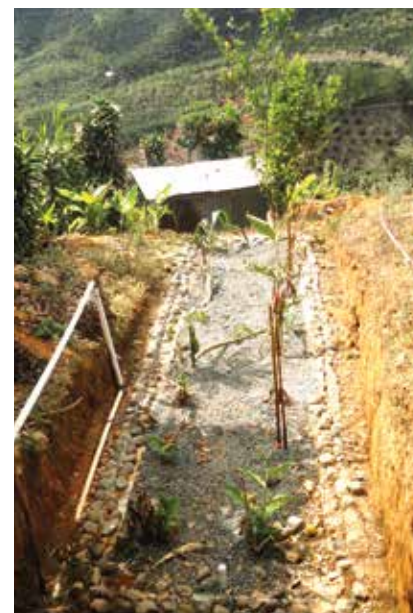
Biojardinera implementada en zona de Los Santos, 2014
