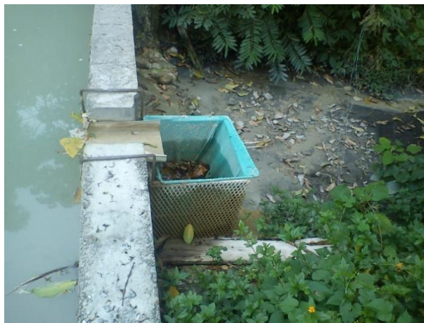
Figura 23. Desfogue al río del sedimentador de la Planta Pozuolli.
