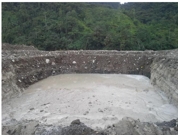
Figura 30. Fosa de sedimentación escombrera 15.
