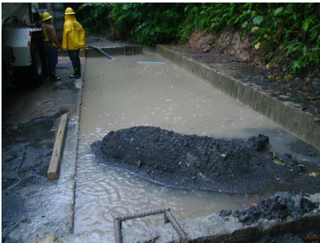
Figura 21. Sedimentador del lavadero de automezcladoras.
