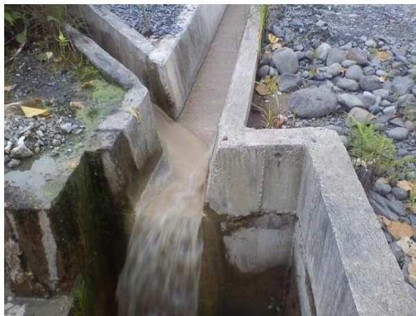
Figura 25. Desfogue al río del sedimentador de la Planta Arbau 120.
