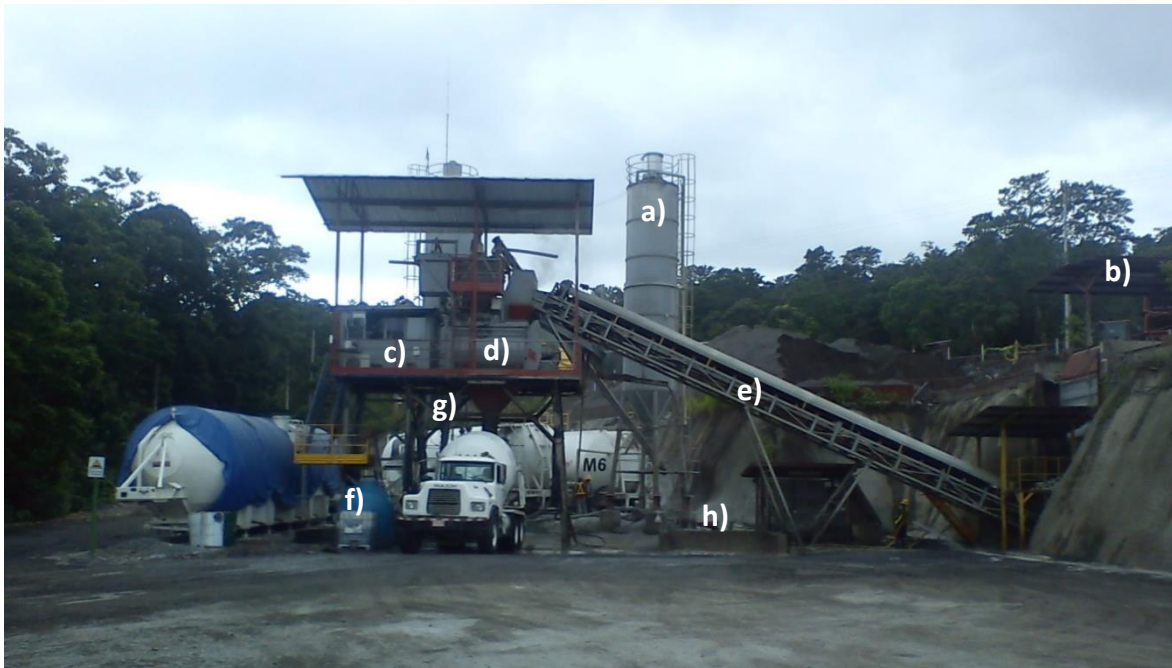
Figura 10. Componentes de la Planta Mezcladora de Concreto Arbau 120, PHR. Fuente: P.H. Reventazón, 2013.
