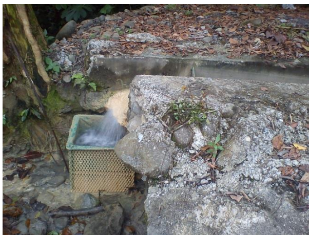
Figura 27. Desfogue al río del sedimentador del Lavadero de Automezcladora.
