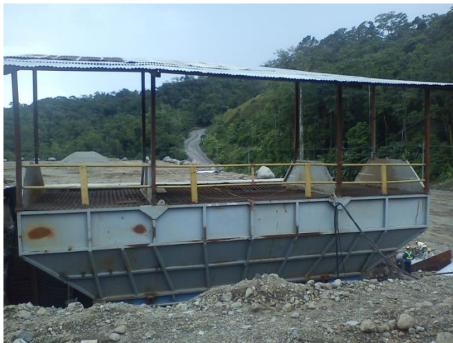
Figura 12. Tolva de agregados.
