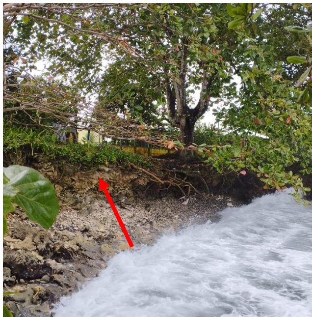
Figura N°6: Foto representativa de la ficha N°6. En la fotografía se muestra el avance de la erosión que socava la cobertura tanto vegetal como artificial a su alrededor (carretera).
