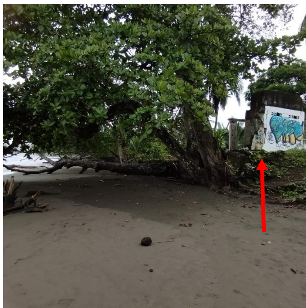
Figura N°8: Foto representativa de la ficha N°8. Se observa una estructura destruida y en abandono y la presencia de escarpes.
