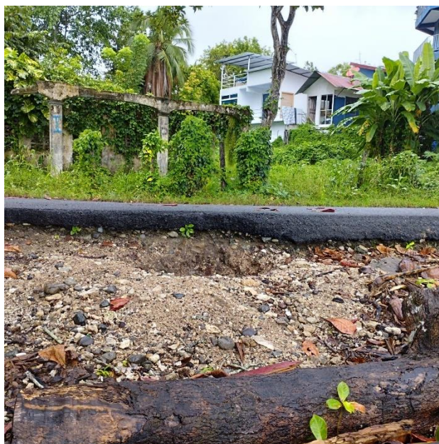
Figura N°3: Foto representativa de la ficha N°3. Se observa el socavamiento de la carretera debido al impacto de erosión que ha afectado la infraestructura.
