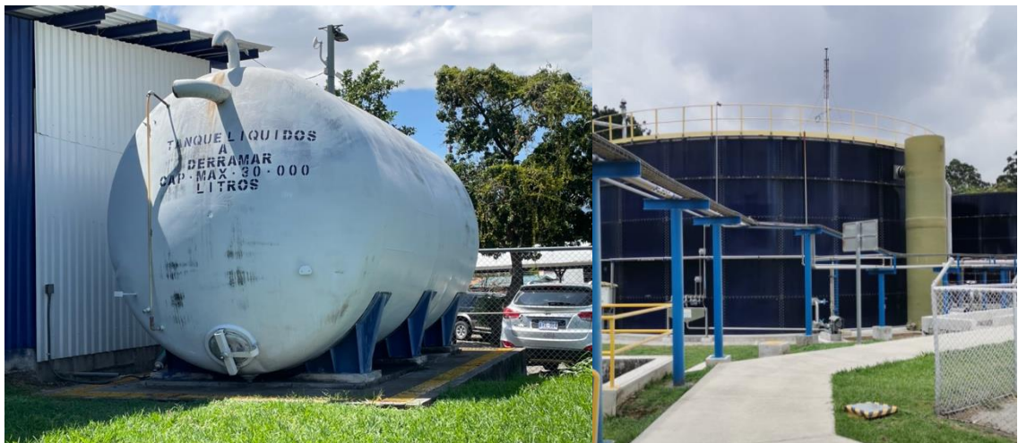
FIGURA 5. TANQUE DE ALMACENAMIENTO DE DERRAME EN PTAR PLANTA REFRESCOS.
