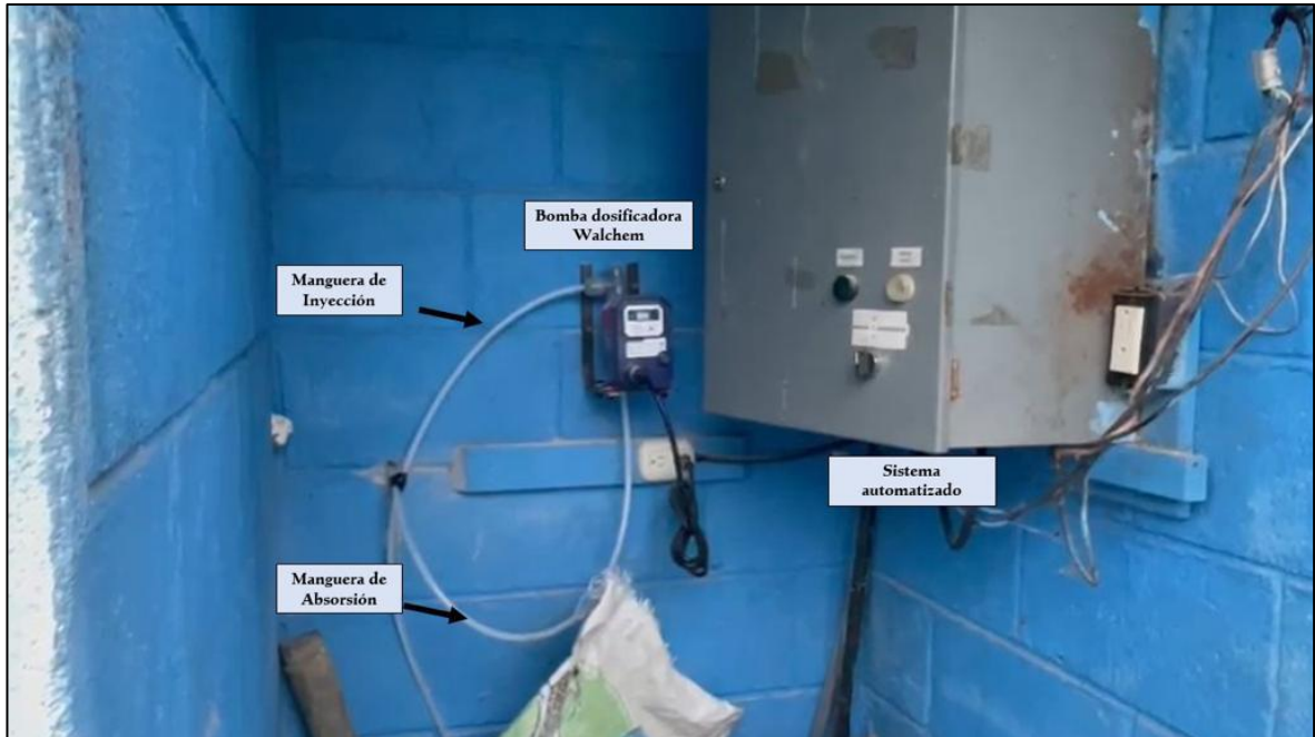
Figura 6.9. Segunda parte de los componentes del sistema de dosificación de cloro instalado en la ASADA El Millal (23 de agosto, 2023).
