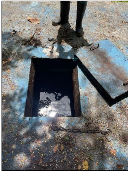
Figura 2.10. Tanque de almacenamiento de la ASADA El Millal.
