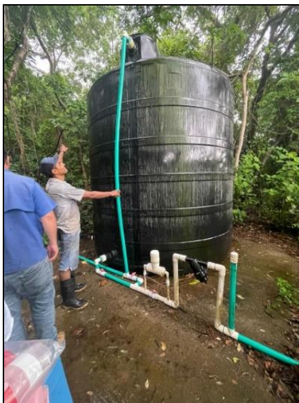
Figura 2.3. Tanque de almacenamiento de la ASADA San Juan, Cañas, Guanacaste.
