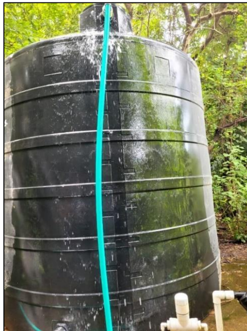
Figura 6.5. Problema de rebalse del tanque de la ASADA San Juan de Cañas (25 de octubre, 2023).
