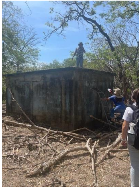
Figura 2.8. Tanque de almacenamiento, ASADA Cañal Pozo de Agua en Nicoya.
