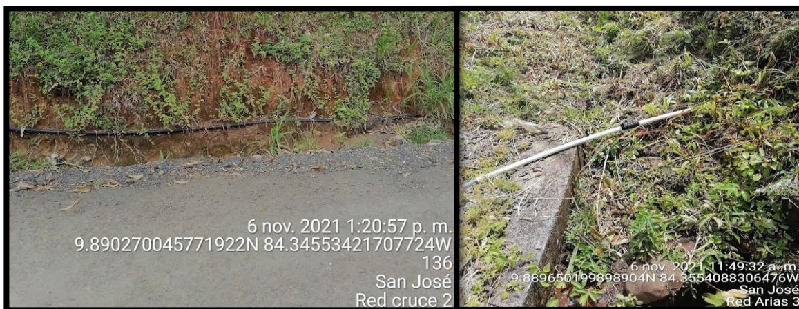
Figura 23. Tuberías de distribución expuestas. Fotografías tomadas durante los recorridos al sistema de distribución de agua potable de la ASADA de Llano Grande.
