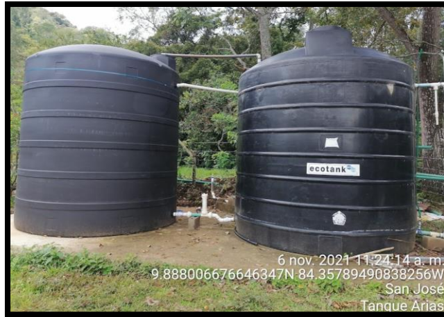
Figura 20. Tanque Arias. Fotografías tomadas durante los recorridos al sistema de distribución de agua potable de la ASADA de Llano Grande.
