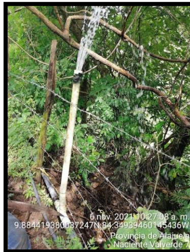
Figura 22. Respiraderos en las tuberías de conducción. Fotografías tomadas durante los recorridos al sistema de distribución de agua potable de la ASADA de Llano Grande.
