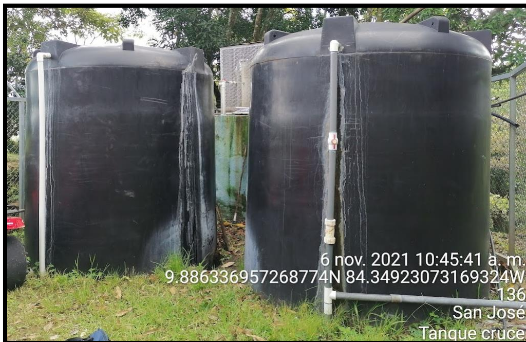
Figura 21. Tanque Cruce. Fotografías tomadas durante los recorridos al sistema de distribución de agua potable de la ASADA de Llano Grande.
