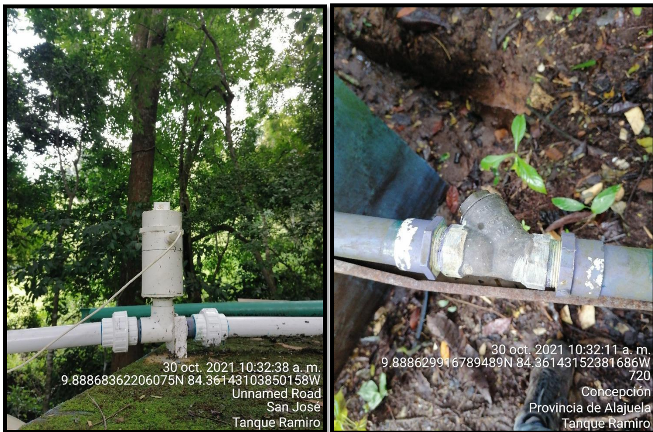
Figura 17. Check antirretorno y clorador en el tanque Ramiro, Fotografías tomadas durante los recorridos al sistema de distribución de agua potable de la ASADA de Llano Grande.
