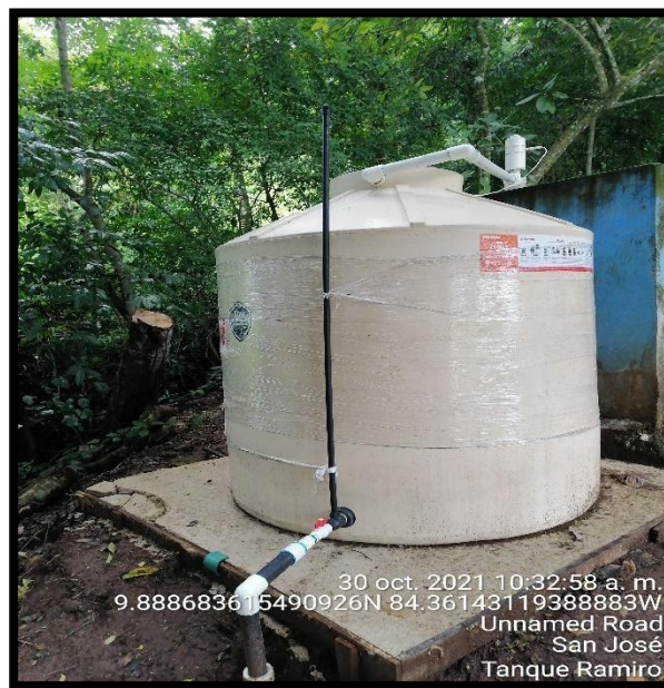
Figura 16. Tanque Ramiro. Fotografías tomadas durante los recorridos al sistema de distribución de agua potable de la ASADA de Llano Grande.
