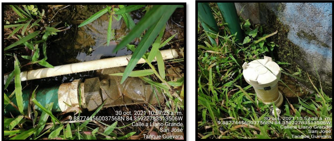
Figura 19. Check antirretorno y Clorador Tanque Guevara. Fotografías tomadas durante los recorridos al sistema de distribución de agua potable de la ASADA de Llano Grande.
