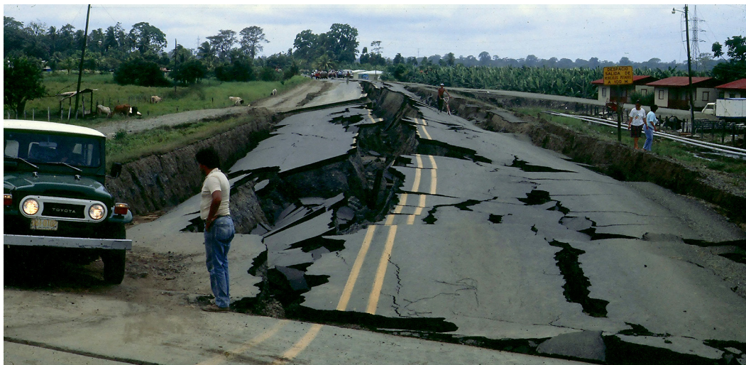
Fig. 7: Desplazamiento lateral y ruptura del relleno compactado de la carretera (RN-32) cerca de la localidad de Río Blanco. Fotografía tomada por Sergio Mora Castro el 24 de abril de 1991.
