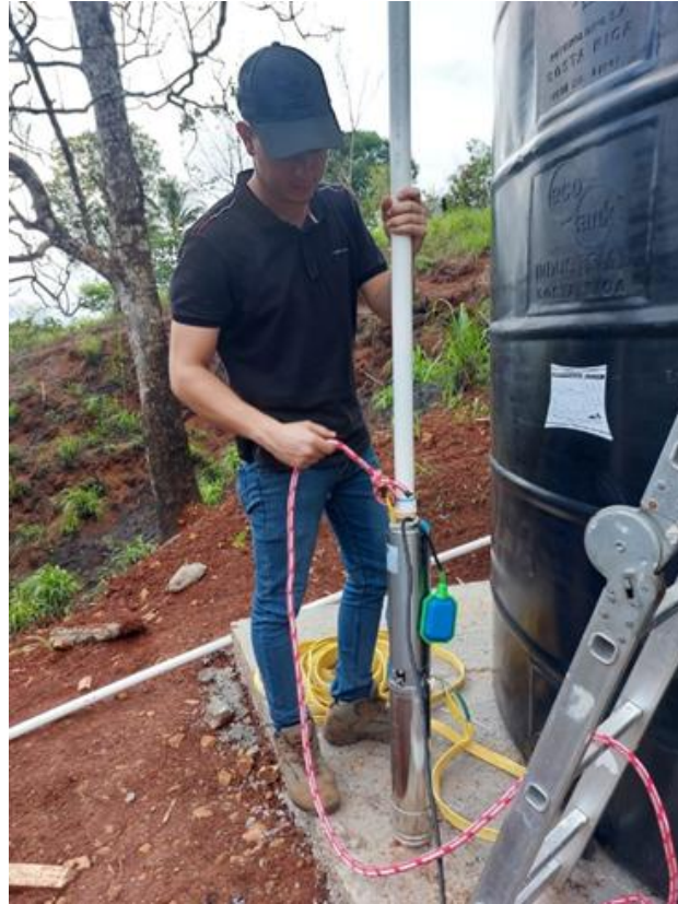
Anexo 6. Instalación de un rebomero en la ASADA de Caimital de Nicoya.
