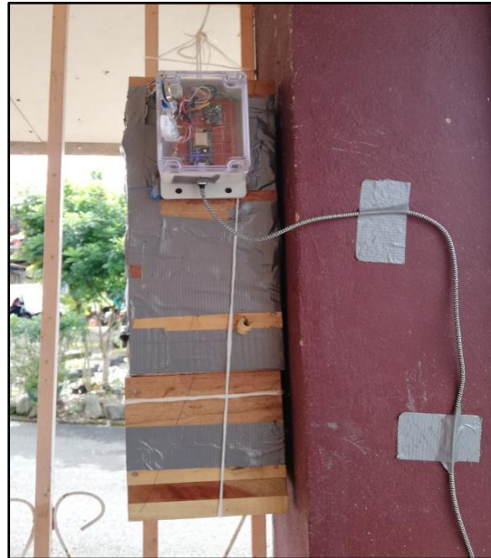
Figura No. 5. Prototipo instalado
