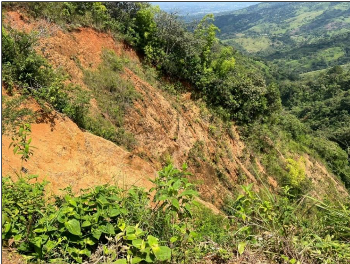
Figura 9: Derrumbe de la plaza de futbol en la RIQ Fuente: Elaboración propia
