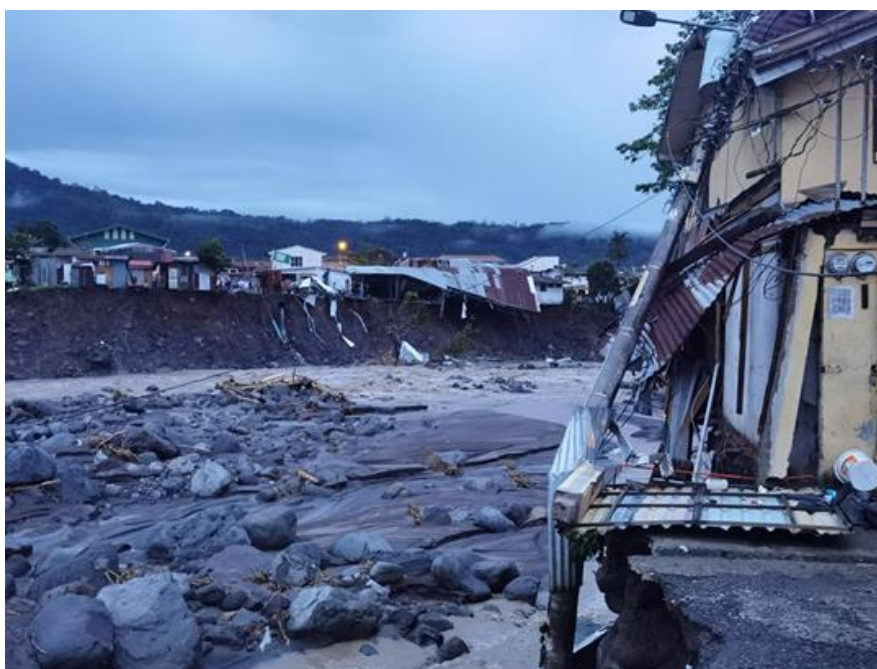
Figura 5. Emergencia año 2021, cantón de Turrialba, por desborde del río Turrialba
