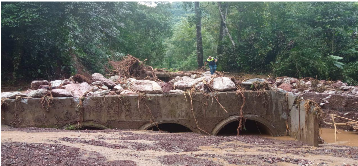
Figura 2. Alcantarillas pluviales obstruidas por las inundaciones, río Copey, Jacó de Puntarenas.
