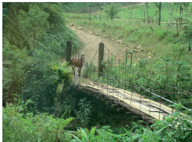
B. Puente en mal estado hacia Río Celeste
