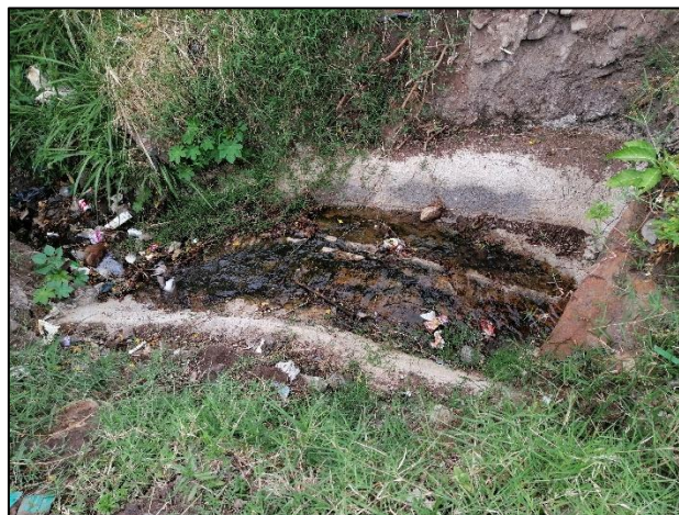
Figura 37. Cauce la de quebrada contaminada por aguas residuales, quebrada Lajas (Santa Ana, San José). Fuente: Elaboración propia
