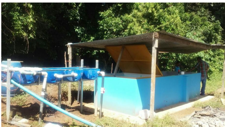
Figura 82: Planta de aguas residuales, sustraído de Frutos y Raíces Tropicales ByB del Sur S.A, (2016)
