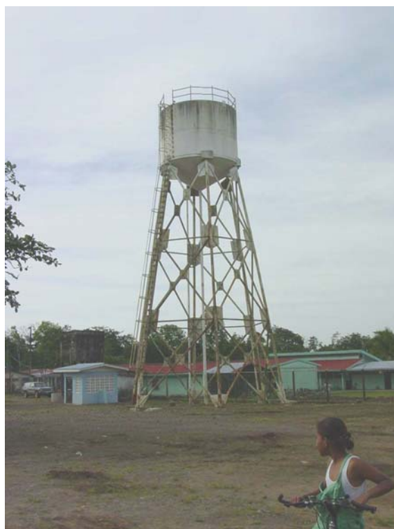
Figura 7: Pozo y tanque Acueducto Rural, El Progreso, Cariari (SENARA-RS09).
