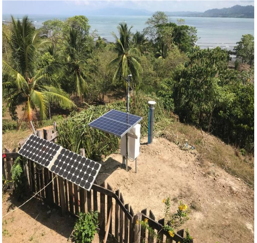
Estación de Monitoreo Geodinámico en Punta Burica, 2025
