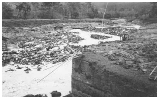
Figura 4: Puente sobre río Pénjamo destruido
