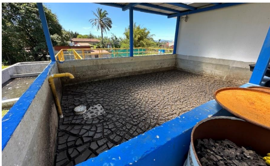
Figura 2.5. Lecho de secado de lodos de la PTAR.
