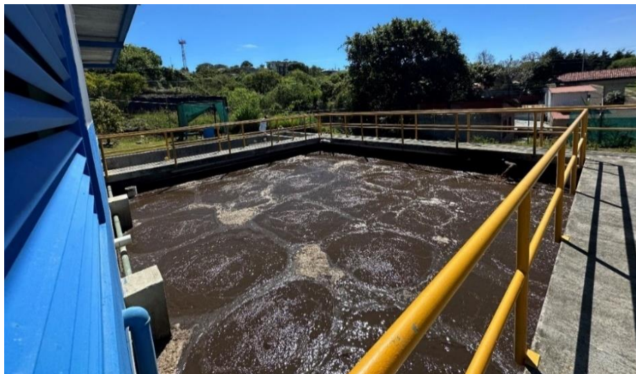
Figura 2.3. Reactor biológico aerobio de la PTAR.
