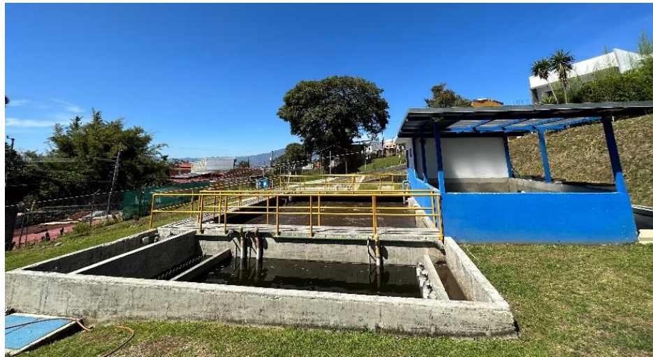
Figura 3.1. Planta de tratamiento de aguas residuales de estudio.
