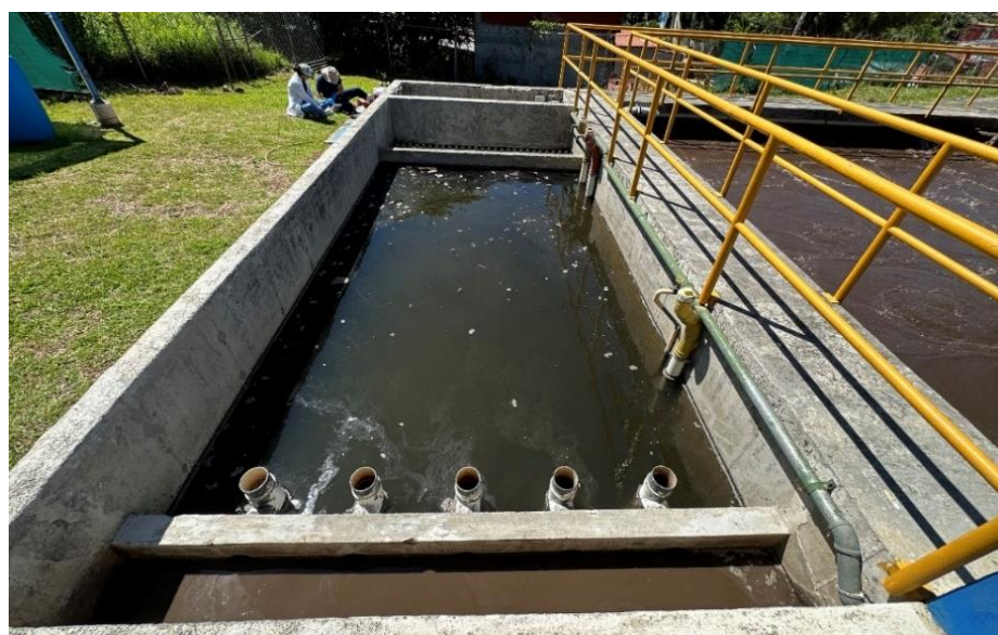
Figura 2.4. Sedimentador secundario de la PTAR.
