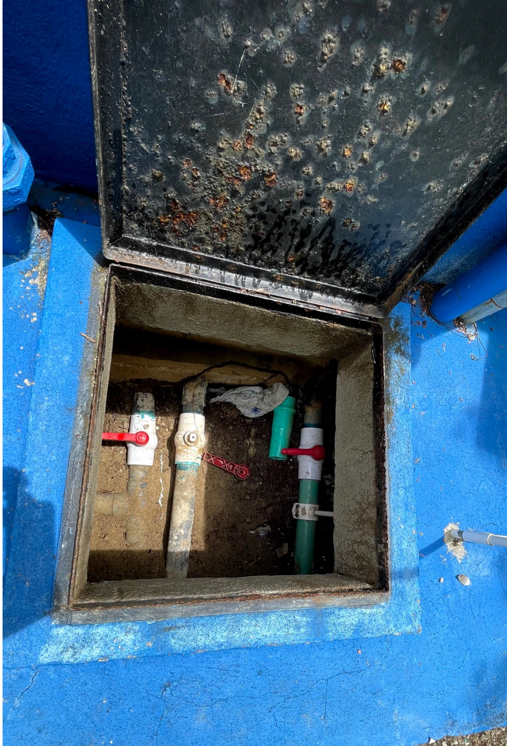
Anexo 3. Estado del macromedidor del tanque de almacenamiento.
