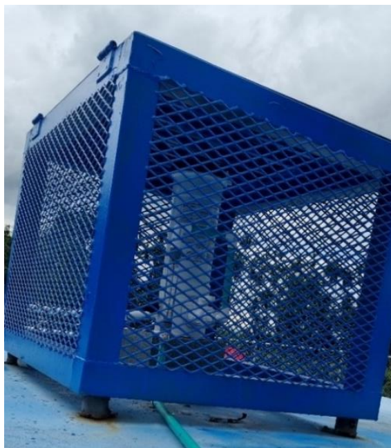
Figura 5. Jaula protectora del dosificador por erosión
