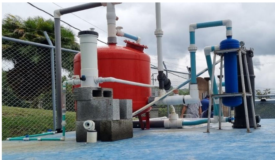
Figura 6. Estación de cloración Bernardino Rodríguez
