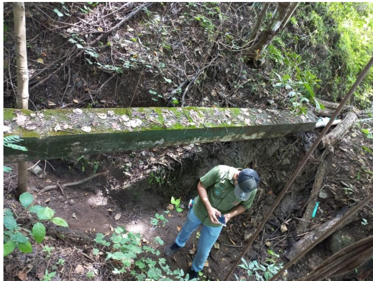
Figura VI.7. Punto crítico, paso a desnivel de la tubería.
