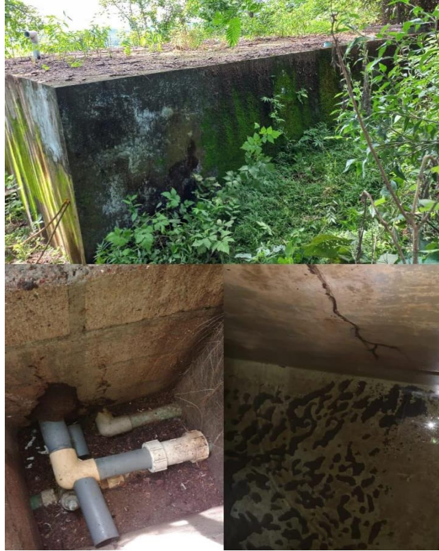
Figura VI.3. Caracterización del tanque de almacenamiento de la ASADA de Peñas Blancas de Colorado de Abangares.
