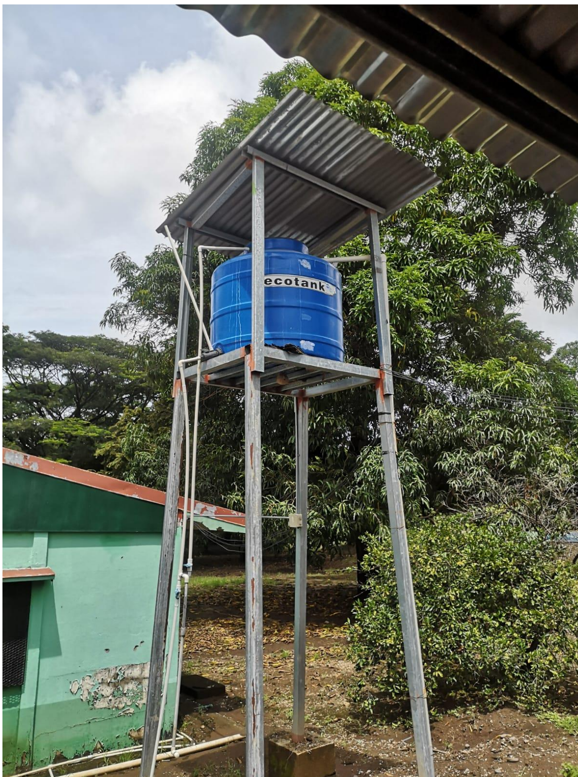
Anexo 12. Tanque de suministro de agua potable para la escuela de Peñas Blancas de Colorado, Abangares.
