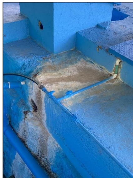
b) Presencia de fugas en el sistema de cloración.
