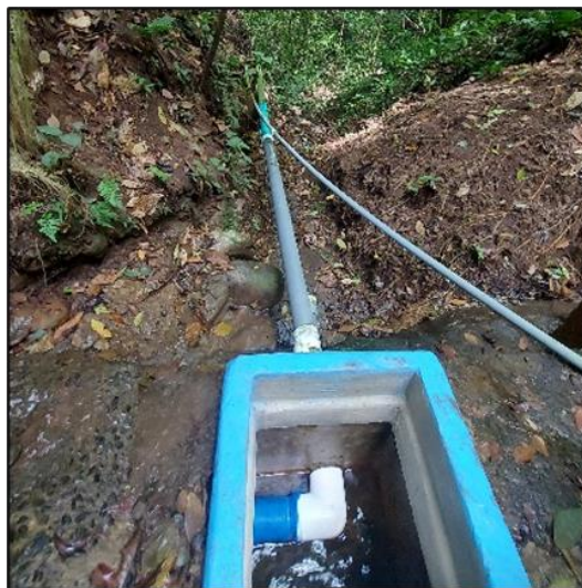
b) Tubería expuesta sin protección ante desastres naturales.
