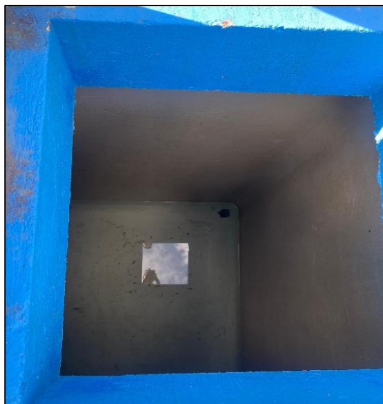
b) Nivel de agua en el que se encuentra el tanque de almacenamiento comúnmente.
