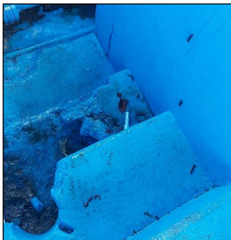
a) Presencia de insectos y grietas en la infraestructura del componente.
