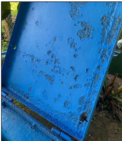
a) Tapas en mal estado en el sistema de almacenamiento El Centro .
