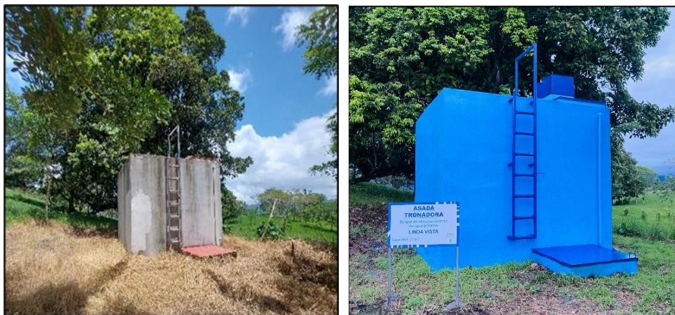
Figura 6.13 Condición del Tanque Linda Vista.
