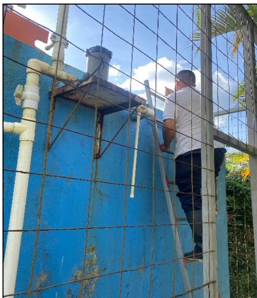
a) Ausencia de puerta para ingreso a la caseta de protección del tanque.
