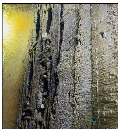
b) Paredes deterioradas de la infraestructura de la naciente Mario Fuentes .
