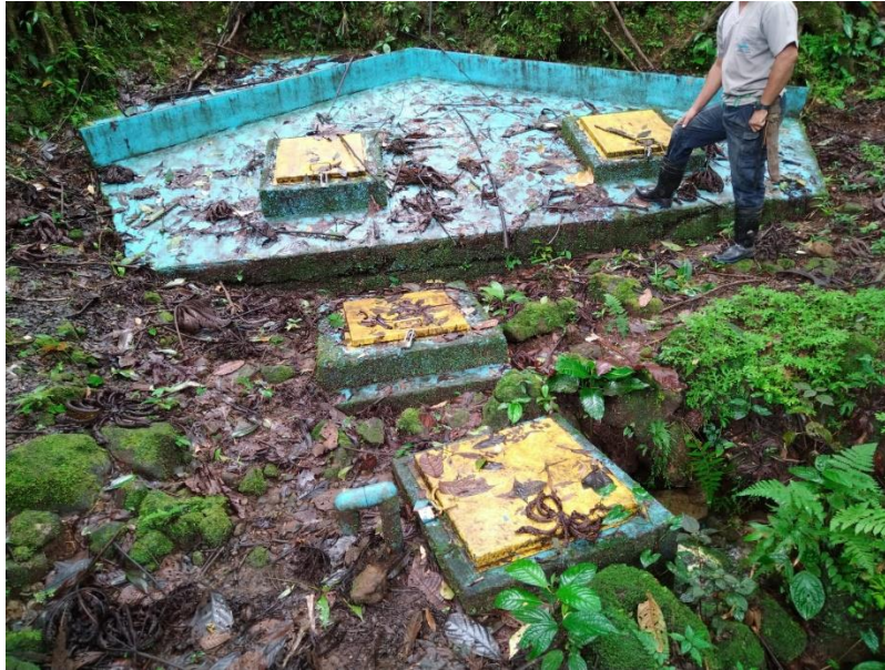
Figura 6.3. Obra de captación de la fuente del subsistema Altamira de la ASADA Bijagua.
