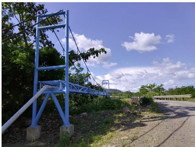
Figura 6.12. Tubería expuesta en la línea de distribución en el sistema de Altamira.
