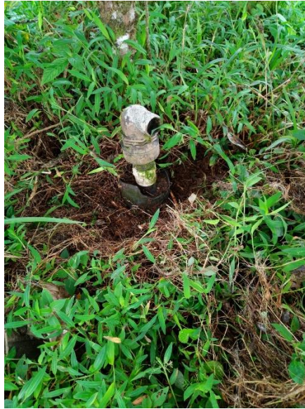
Figura 6.5. Válvula eliminadora de aire dentro de la línea de conducción
