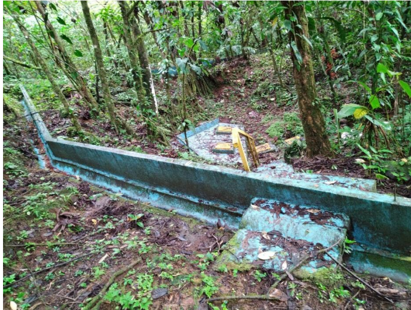
Figura 6.4. Canales perimetrales de escorrentía de la obra de captación de la fuente de Altamira
