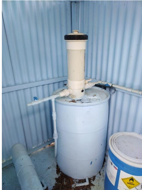
Figura 6.8. Sistema de cloración del sistema de Altamira de la ASADA Bijagua
