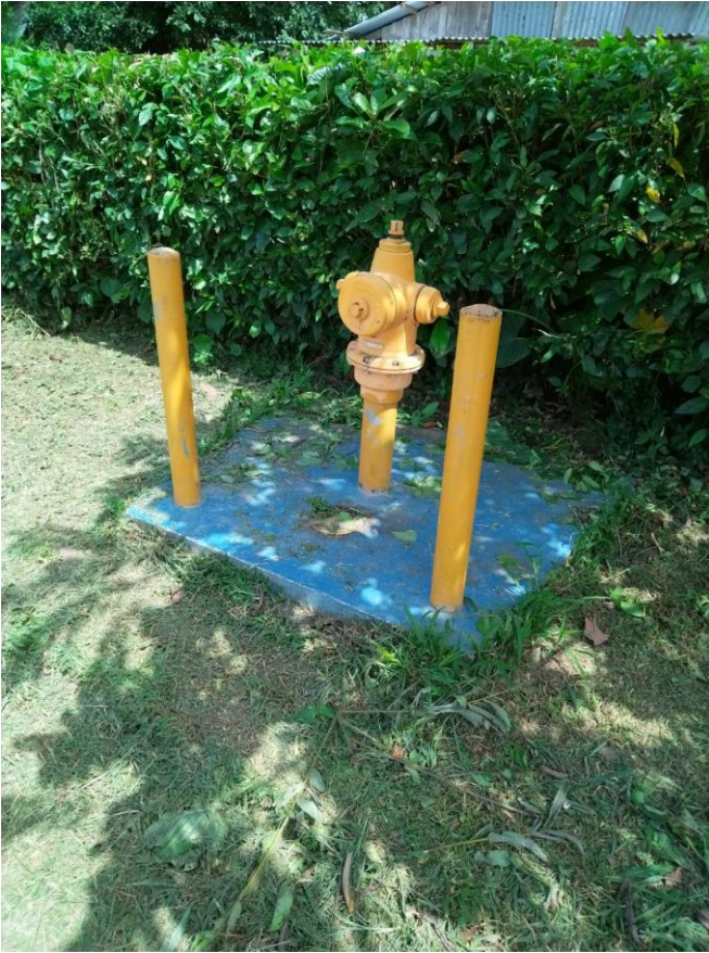
Anexo 6. Ubicación de hidrantes en la red de distribución del sistema de Altamira
