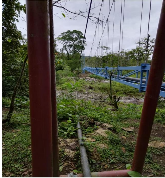
Figura 6.6. Tubería expuesta en la línea de conducción
