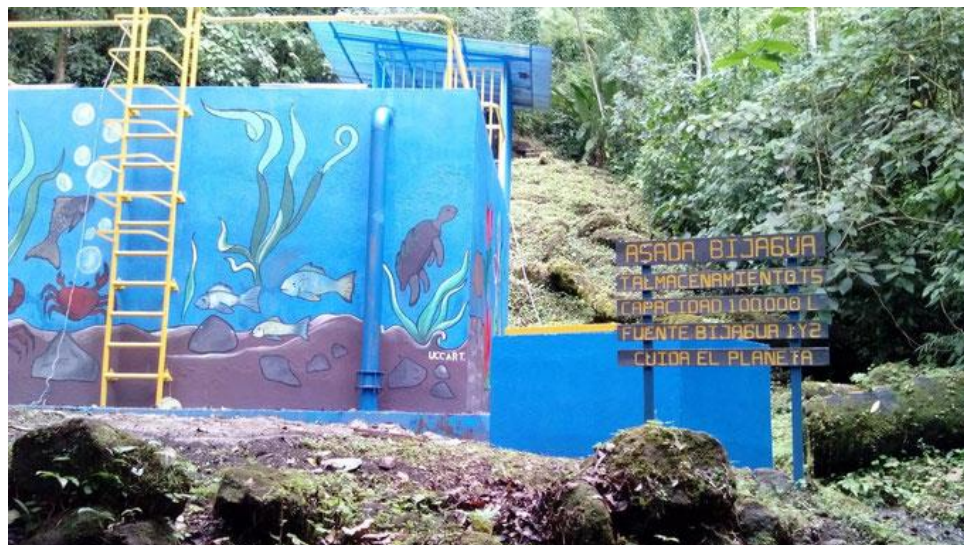
Figura 2.5. Tanque de almacenamiento de la fuente Bijagua 1
