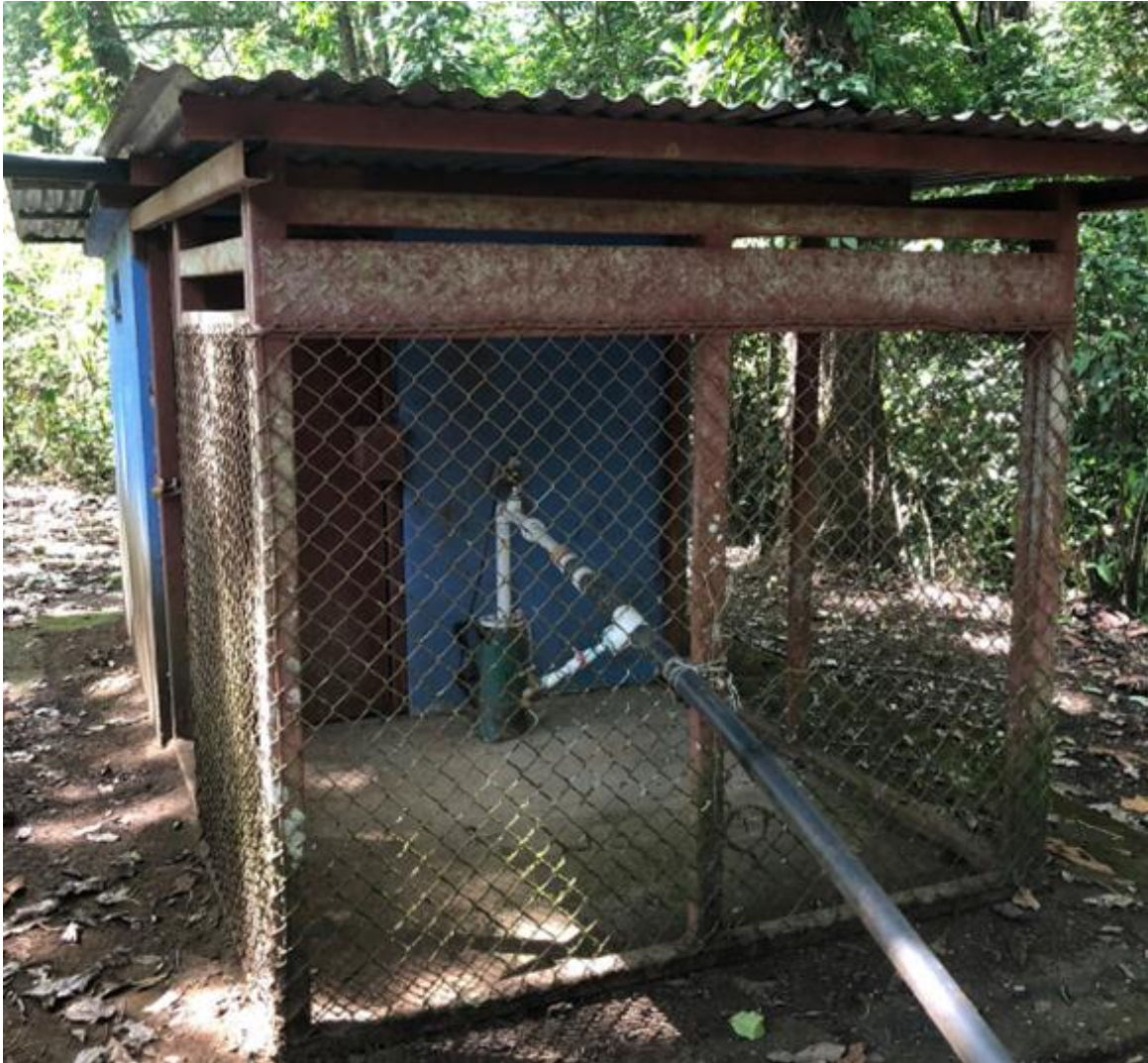
Figura 13. Pozo de bombeo de la ASADA Juan Díaz.
