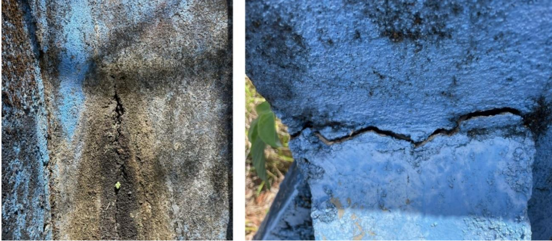
Figura 16. Daños ubicados en el tanque abastecimiento de la ASADA Juan Díaz.
