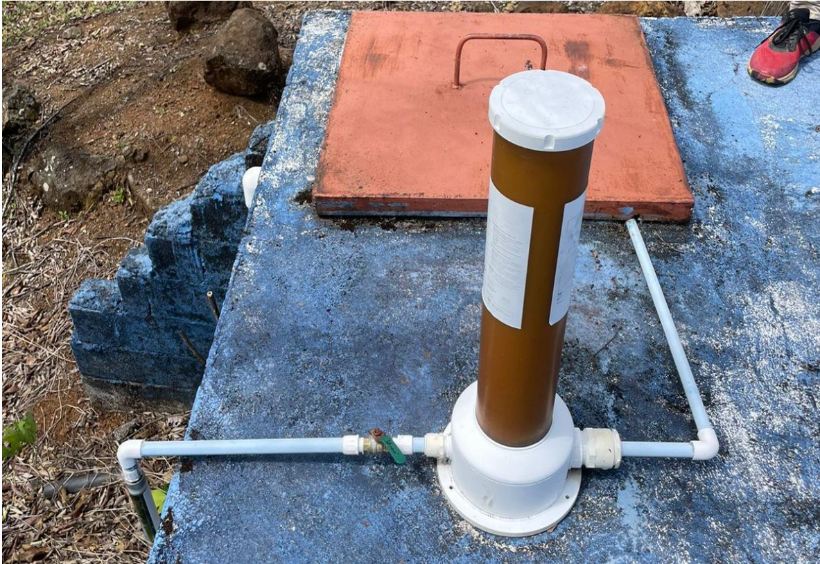
Figura 17. Sistema de cloración del tanque.
