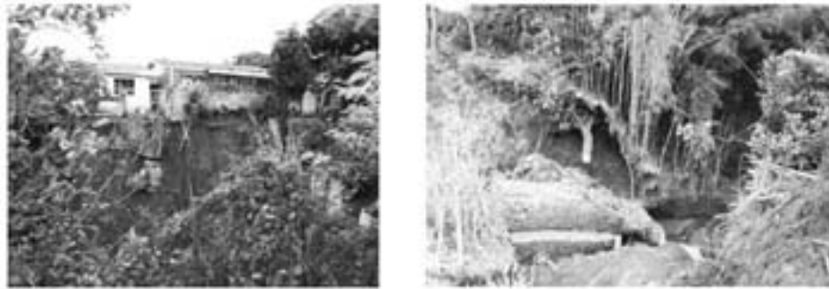
Foto 7. Inestabilidad de las laderas en el cauce del río, sector San Rafael (al costado del Depósito) Derecha. Nótese la ubicación de la vivienda respecto al borde del talud. Izquierda. Gaviones instalados en eventos anteriores con el objetivo de proteger el talud. Sin embargo estos también fallaron debido a un mal diseño. Tomada por Marilyn Romero, 2009.
