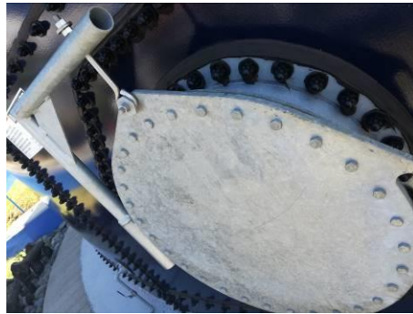
Figura 53. Estado de las válvulas de cierre
