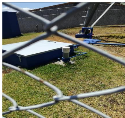
Figura 55. Tubo de cloración cerrado
