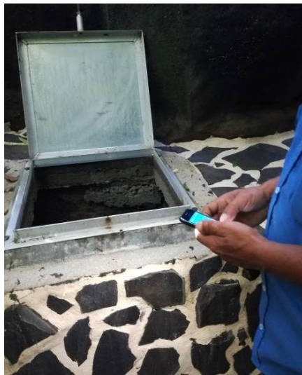
Figura 36. Estado de la superficie
