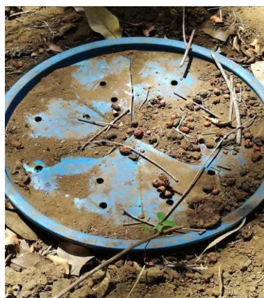
Figura 41. Revisión de tapa de tanque cerca de Plantex
