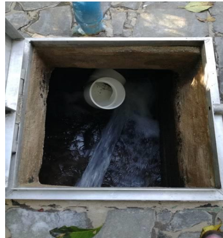
Figura 26. Estado del tanque
