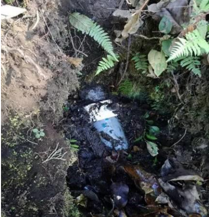
Figura 37. Tubería con fuga
