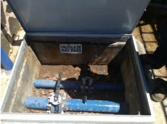
Figura 4. Rótulo de válvula de By Pass.
