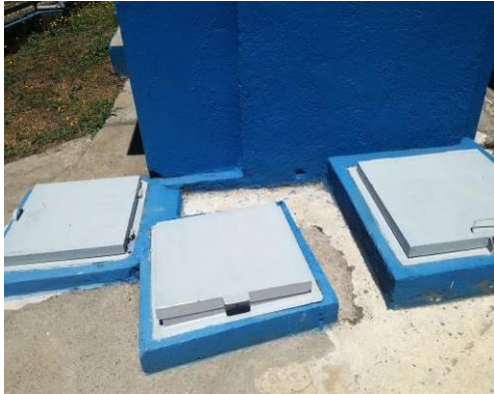
Figura 5. Tapas en buen estado, pintadas y cerradas.
