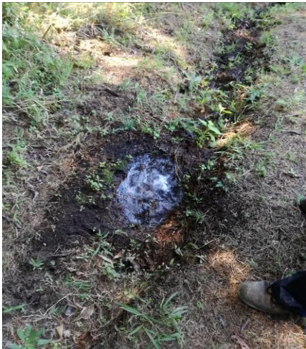
Figura 39. Fuga expuesta en tramo
