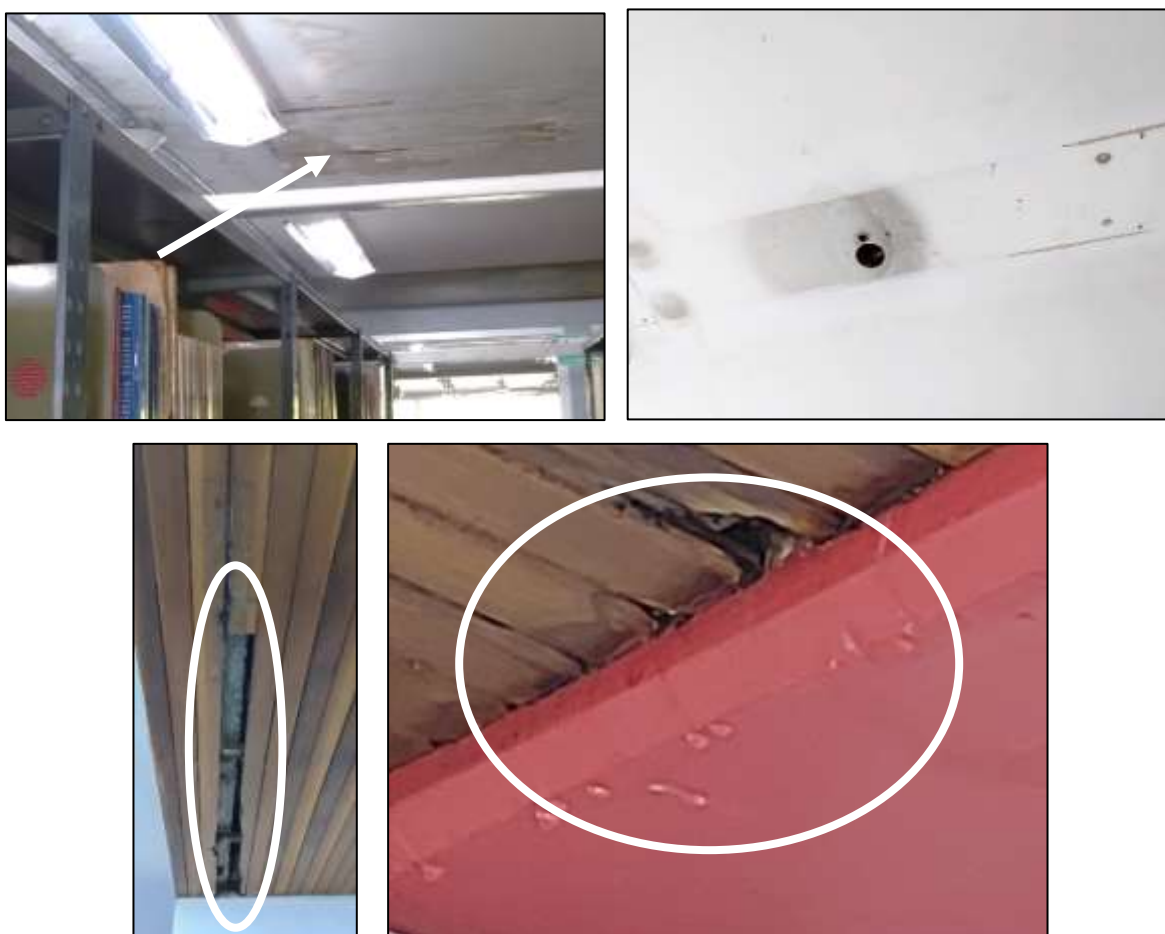
Figura 19 Daños en el cielo raso del primer nivel, 2023
