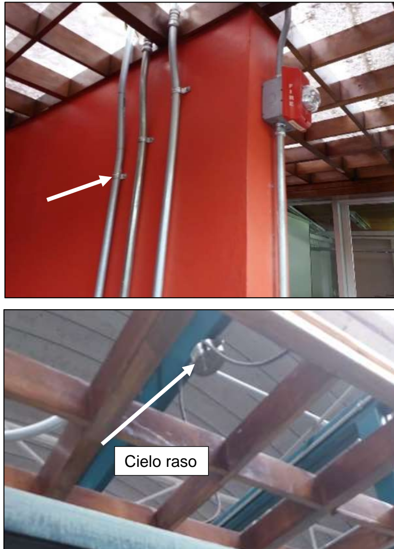
Figura 24 Instalaciones eléctricas de la BJGM, 2023
