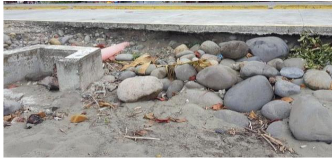
Figura 10. Bulevar de Cieneguita, zona socavada por el agua de mar Fuente: Proyecto Erosión Costera del Caribe sur de Costa Rica; impacto ecosistémico y vulnerabilidad social, Cieneguita.
