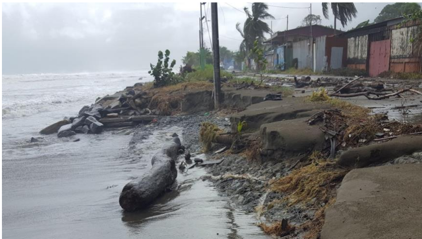
Figura 15. Afectación de tendido eléctrico en Cieneguita
