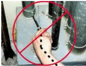
Herramienta de largo de mango inadecuado
