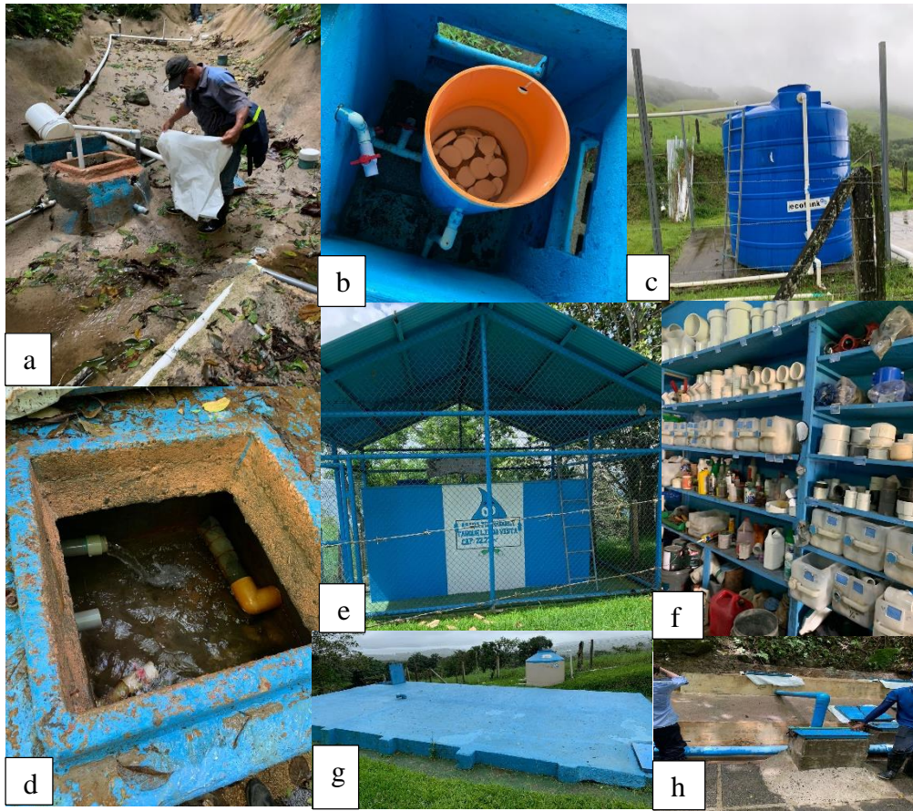
Figura 11. Fotografías del sistema de abastecimiento de la ASADA de Tronadora de Tilarán a: nacimiento, b: sistema de cloración, c: tanques de plástico, d: cámaras de las nacientes, e: tanques de almacenamiento, f: bodega de la ASADA, g: tanque enterrado, h: tuberías de las nacientes.
