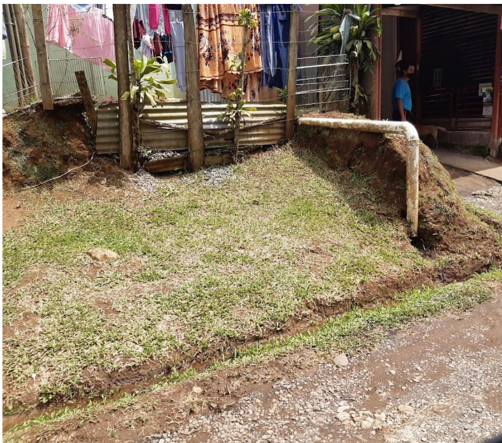
Figura 12. Evidencia de la ausencia de un alcantarillado pluvial en la parte media de la subcuenca
