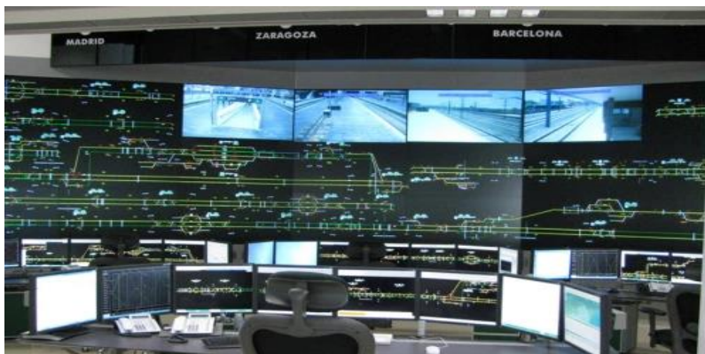
Figura No. 8: Centro de control ferroviario.
