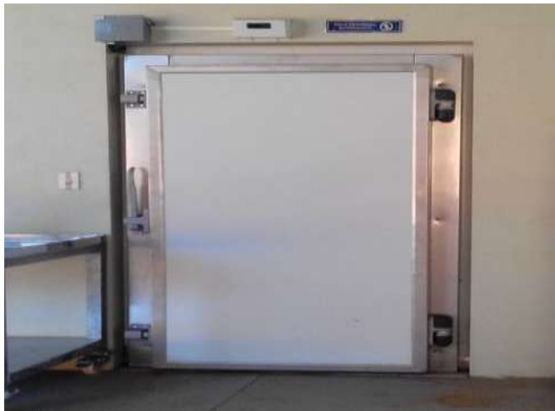
Figura 38. Cuarto de enfriamiento, elaboración propia, 2016.
