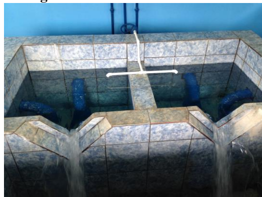
Fotografía 5. Aforo sistema de cloración
