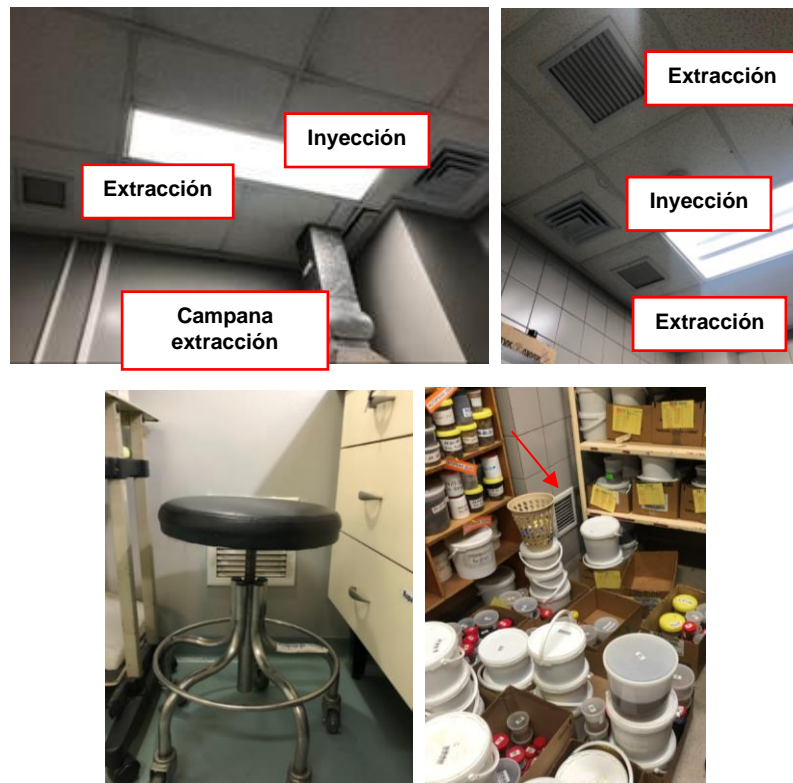
Figura 5.3. Inadecuada ubicación de rejillas en diferentes recintos.
