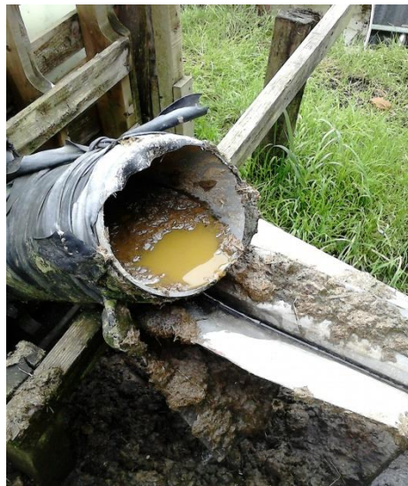
Figura 2. Expulsión del efluente del biodigestor
